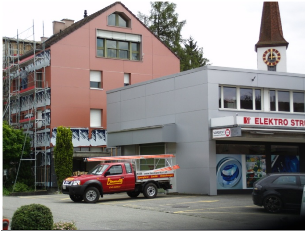
Minergie-Fassade Etalbond Crystal Pink 313
